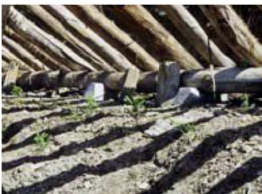
Temporäre Lawinerverbauungen aus Holz schützen etwa 30 Jahre lang vor Lawinen, dann verrottet das Holz. Foto: Corsin Flepp
